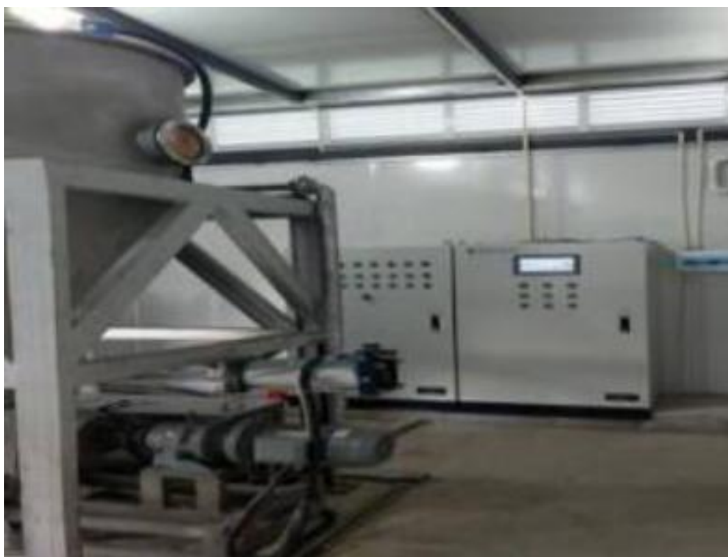
图 11 学校厨余垃圾自动处理系统
